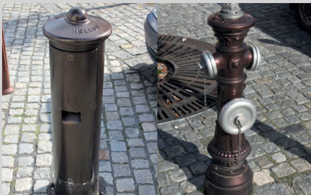
hydranty, sloupky el. napájení
